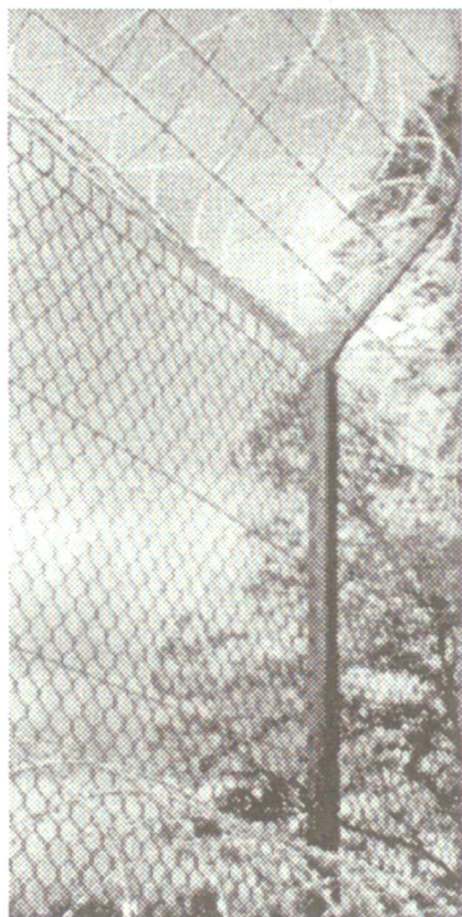
Obr. 2-12: Vrcholová zábrana žiletkovým drátem.
