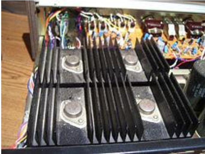
Výkonové MOSFET tranzistory s chladičmi pre výkonový TRM-800 audio zosilňovač
